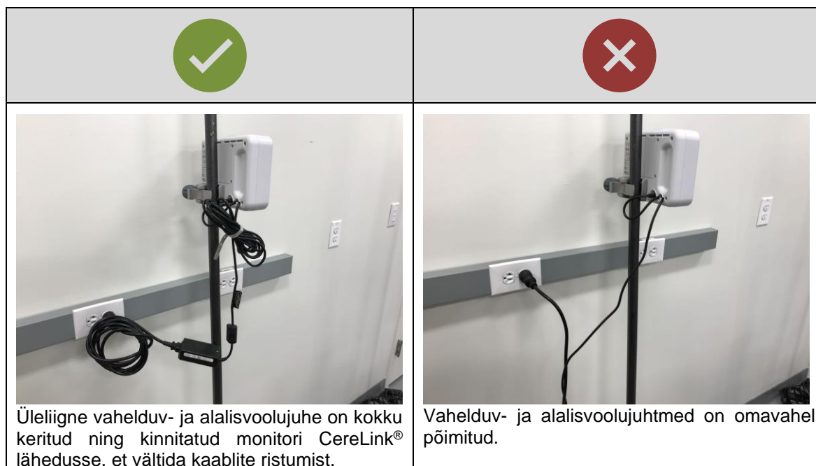
Joonis 1. Läbimõeldud kaablipaigalduse näide
